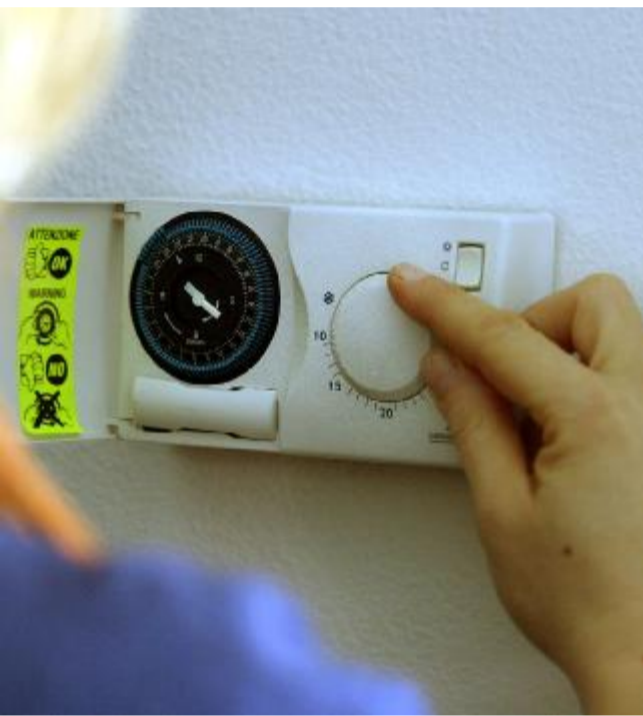
Un termostato dell'impianto di riscaldamento di un'abitazione
